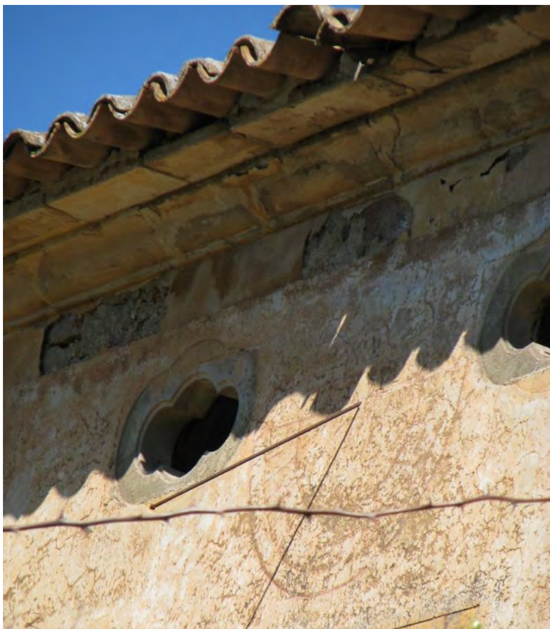
Pintado sobre el enlucido en la fachada sur de la celda nº 3 muy cerca de la cornisa. Se encuentra en muy mal estado de conservación. Se distinguen algunas líneas horarias, algunos números, la fecha y las iniciales F. M. en el interior de un pequeño remate semicircular. Varilla de un apoyo.
