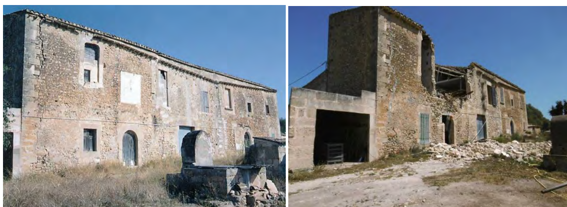
Diario de Mallorca - S. Sansó / 23.06.2016. ARCA. Fotos de la noticia. La fachada de Son Mas antes y después del derrumbe.
