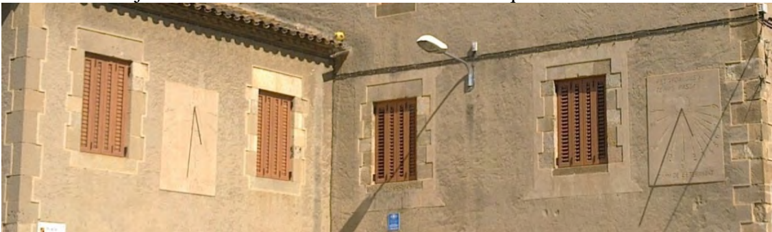
Al sacar los esquinales lo destruyeron. El reloj VDL está a la derecha de la ventana.
