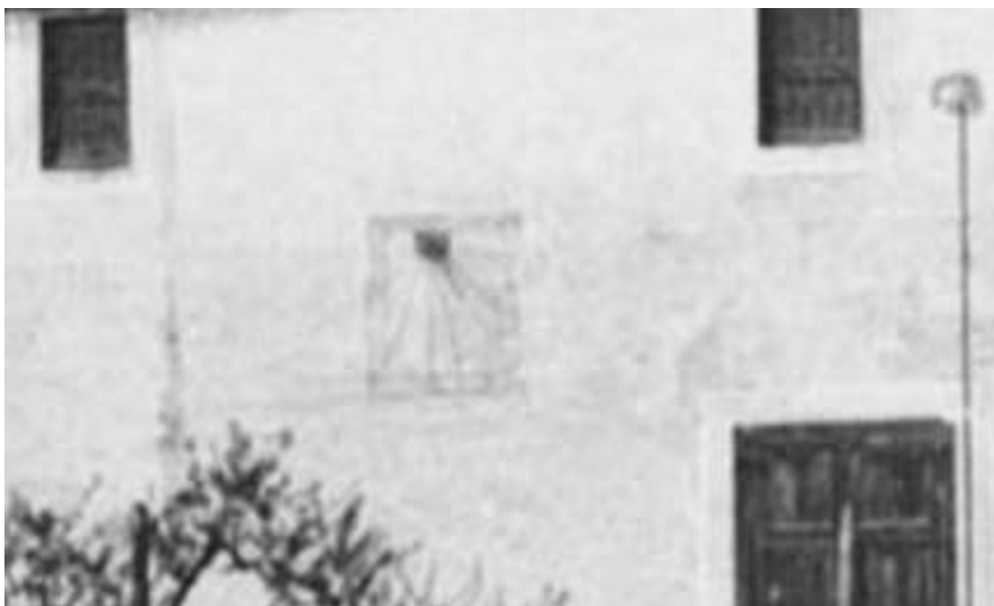
Rectangular. Polo desplazado a la izquierda. Vertical declinante a poniente. Varilla de un apoyo.
