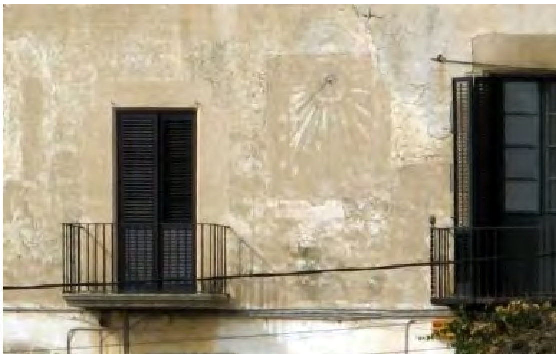
La fachada ha perdido el encalado.
