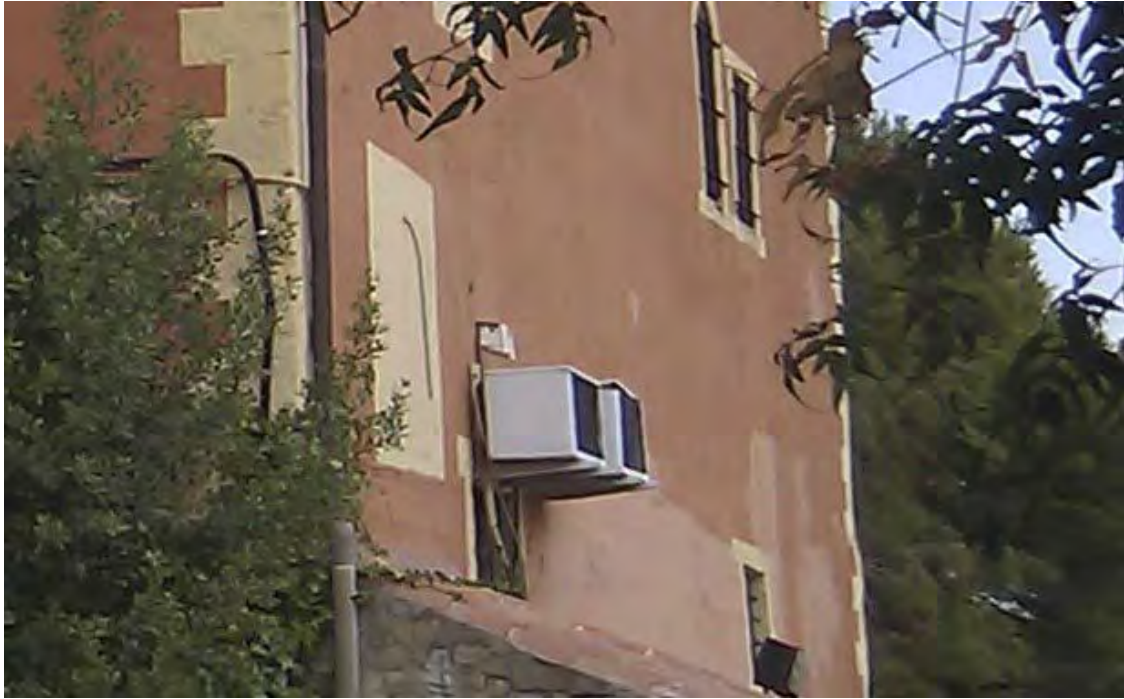
Rectangular vertical. Varilla de un apoyo mal orientada.
