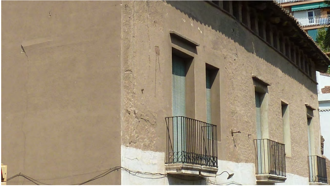
Solamente queda la varilla.
