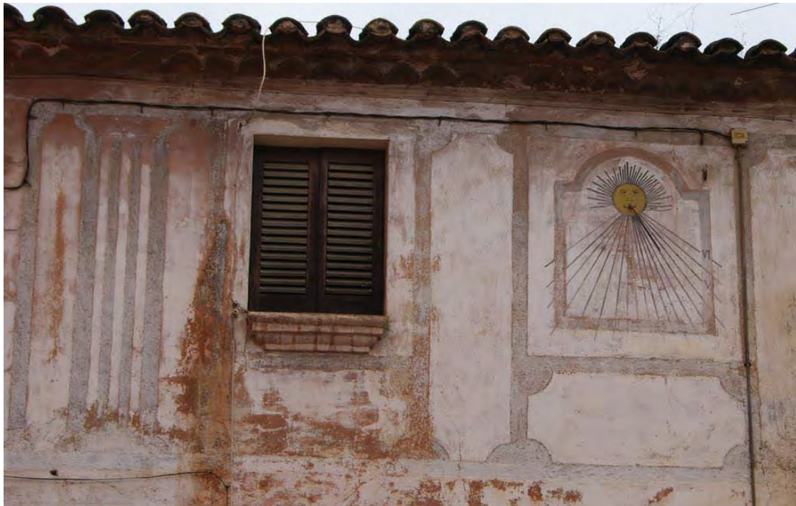
La traza original ha desaparecido en una mala restauración.
